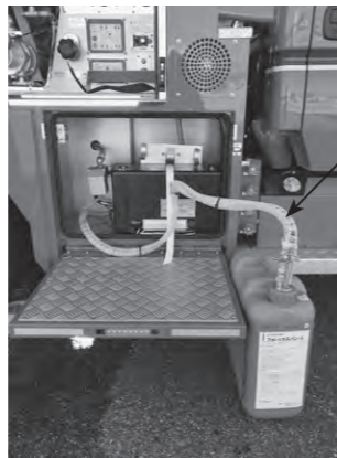
消防車 泡原液吸入口
