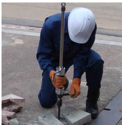
コンクリート破壊
